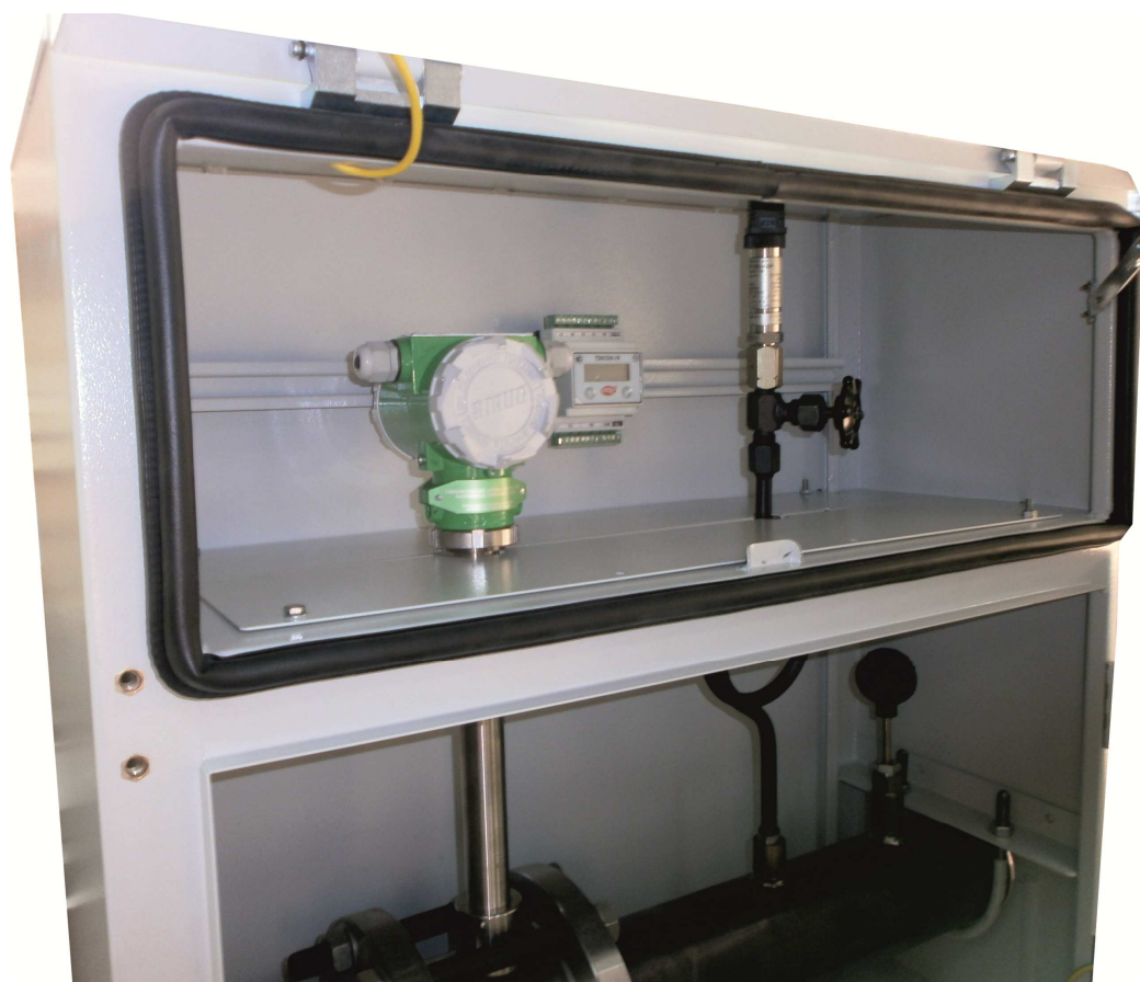
Рисунок 2.12 – Внешний вид трубного шкафа с установленным узлом и функциональной аппаратурой
